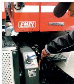
Hitzeschutz: Gut zu sehen sind die hitzegeschützten Leitungen auf der Beifahrerseite neben dem AdBlue-Tank.
